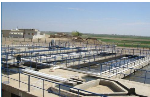
معالجة مياه الصرف الصحي: حوض الترسيب النهائي - الكرامة - الرقة
